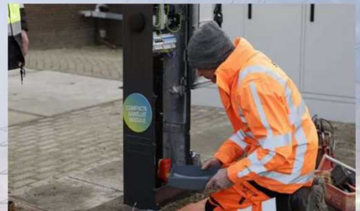
Foto: Laadpalen en straatverlichting drie keer sneller aansluiten met nieuwe, compacte aansluitmodule
